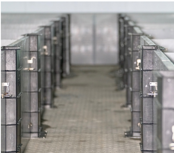
Répartition de l'air par poteaux dans la salle
